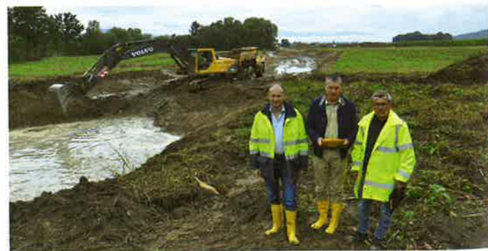
Erste Bauarbeiten bei der Laufverschwenkung Lavant Mettersdorf (= Hauptmaßnahme im Projekt Life+Lavant). Am Bild von rechts nach links: DI Werner Mittl, TDC-ZT-GmbH, Örtliche Bauleitung (ÖBA); Bgm. Peter Stauber, Obmann-StV. Wasserverband Lavant (Bauherrnvertreter) und DI (FH) Siegfried Juri, Wasserbauverwaltung St. Andrä (örtlicher Projektverantwortlicher) und GF Wasserverband Lavant (Bauherrnvertreter).
